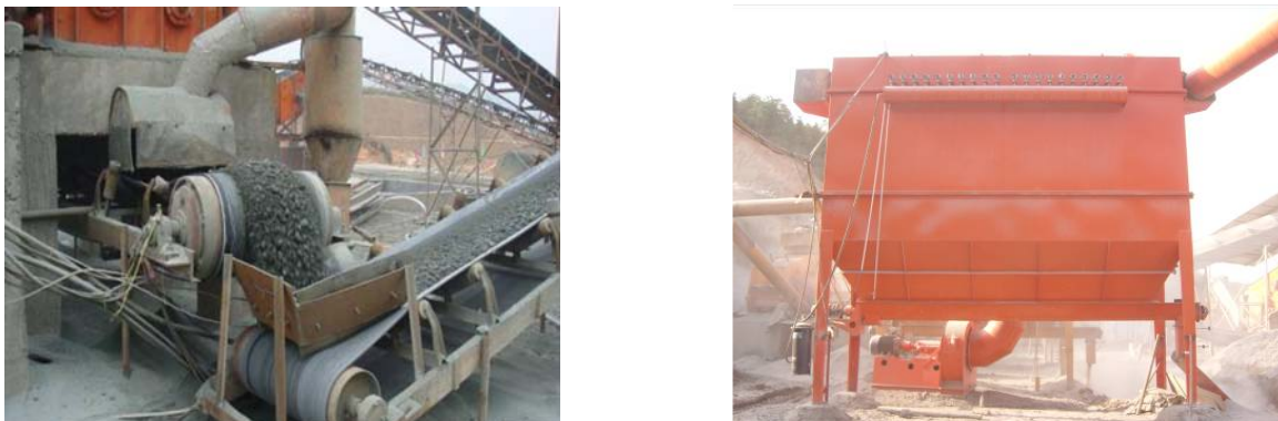
图 6.7.4-1 干式除尘装置
